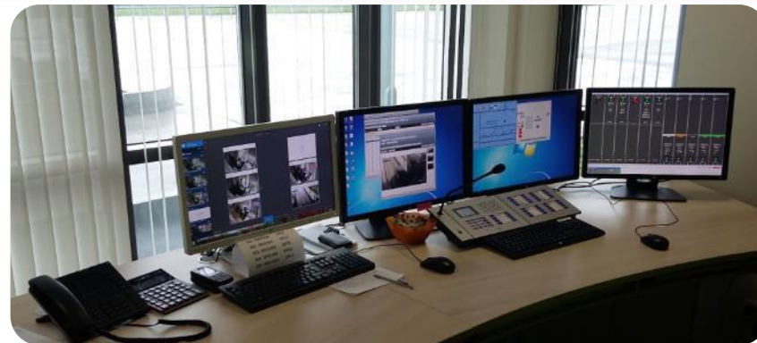
Serveur de Gare & Systeme central
